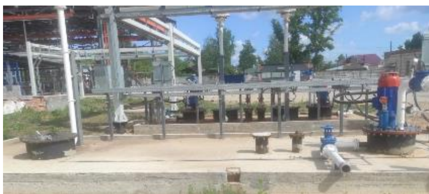
Рисунок 3 – Общий вид резервуаров стальных горизонтальных цилиндрических РГСП
