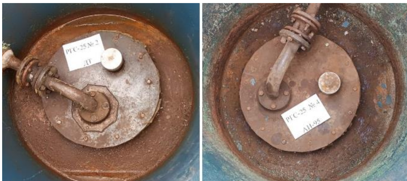
Рисунок 2 – Горловины резервуаров РГС-25 зав.№№ 2, 4
