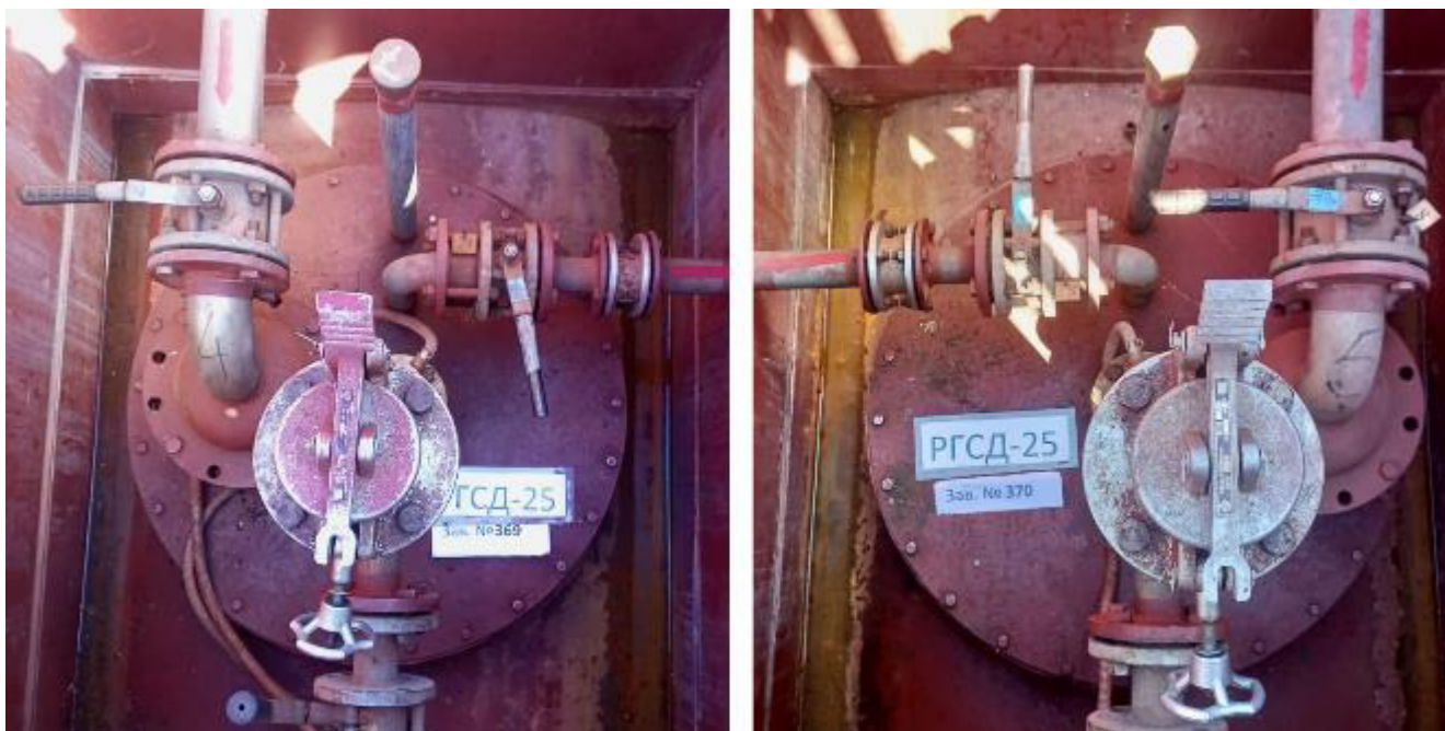
Рисунок 2 – Горловины и измерительные люки резервуаров РГСД-25 зав.№№ 369, 370
