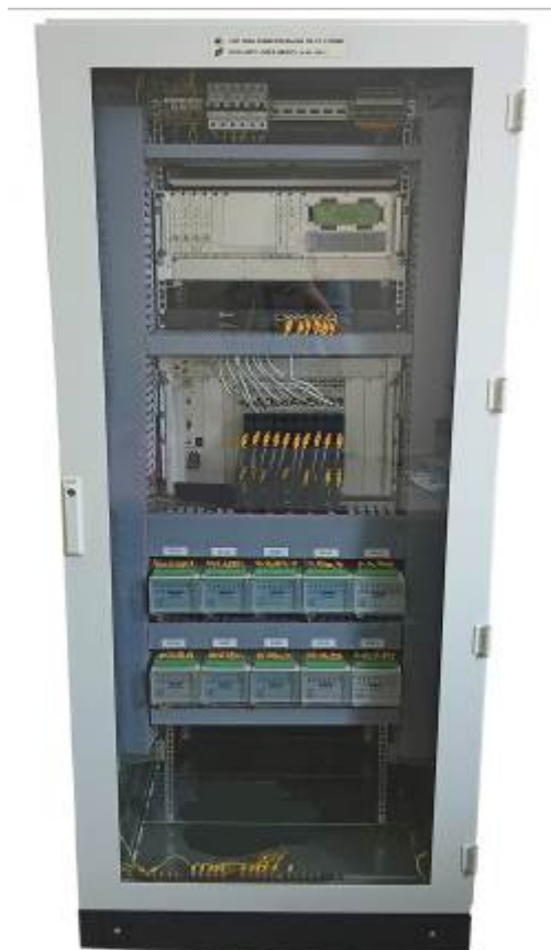
Рисунок 2 – Шкаф измерительного оборудования ШИО
