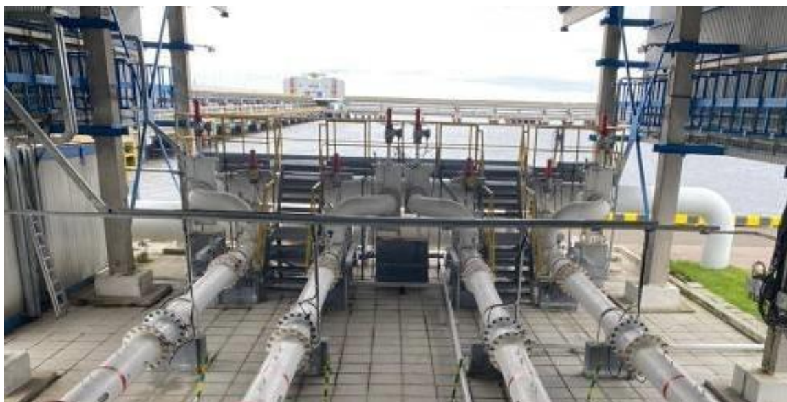
Рисунок 1 – Общий вид СИКН
