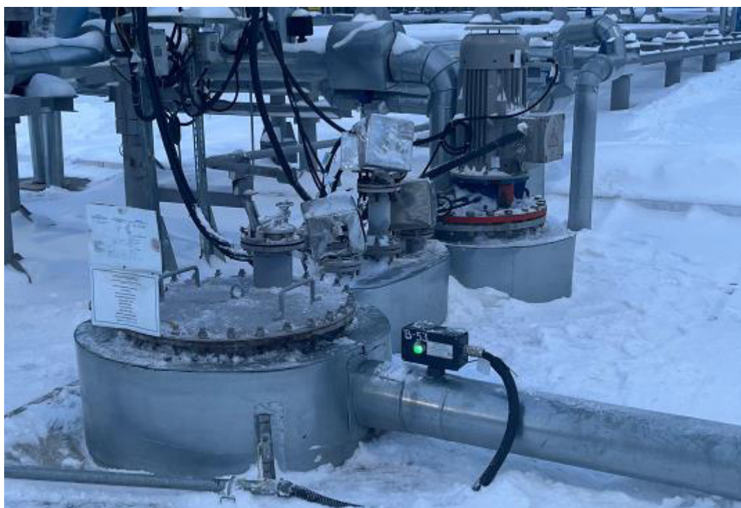
Рисунок 2 – Горловины и измерительный люк резервуара ЕП-16 зав.№ 1095
