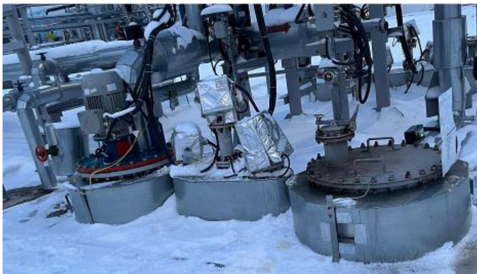
Рисунок 3 – Горловины и измерительный люк резервуара ЕП-16 зав.№ 1099
