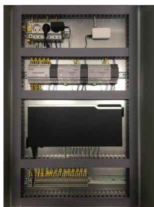
б) комплектный шкаф, с установленным в нем коммутационным оборудованием
