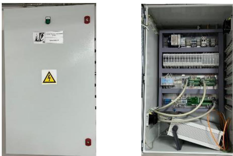
Рисунок 7 – Кросс-шкаф 3 с закрытой и открытой дверцей
