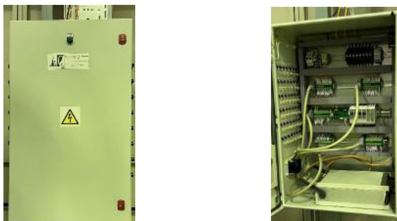
Рисунок 5 – Кросс-шкаф 2 с закрытой дверцей и с открытой дверцей
